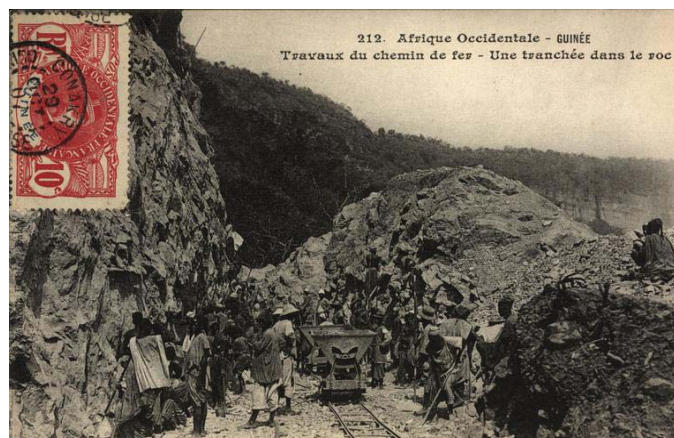
Fig. 4.14 Afrique Occidentale – Guinée – Travaux du Chemin de fer – Une tranchée dans le roc 27
