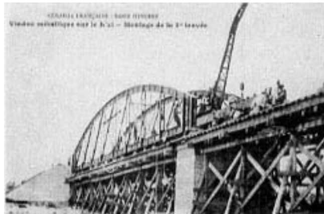
Fig. 4.2 Colonie Française – Côte d’Ivoire – Viaduc métallique sur le N’zi – Montage de la 1 er travée 14
